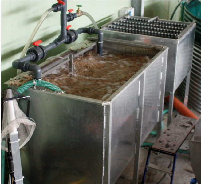
Moving Bed Biofilter mit nachgeschaltetem Absetzbecken für abgestorbene Biomasse
